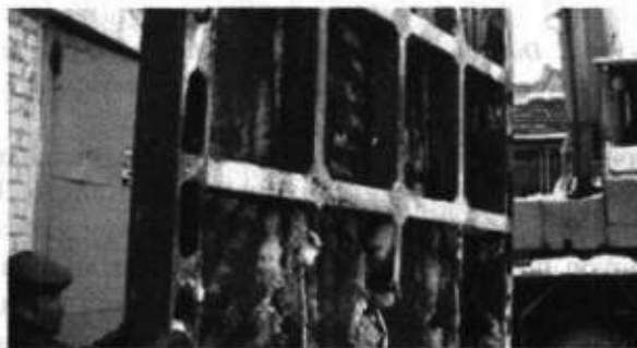
3.3 - rasm. Do'stlik kanalini PK 260 va PK 580 da joylashgan gidrouzellarga o'rnatilgan zatvorlarda yuz bergan korroziya hodisasi
