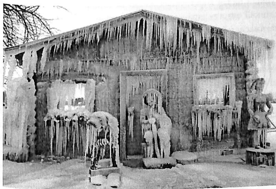
2.18-расм. Бино деворининг (ташқи тўсиқ конструкциясига) ташқи сирти муз билан бутунлай қопланган ҳол
